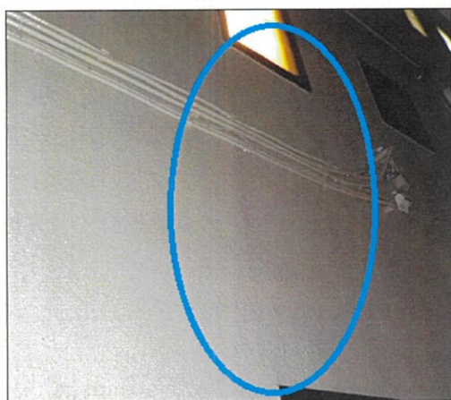
浴室窓から外壁に水が垂れている
